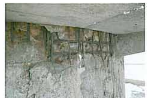
Detail Schadenaufnahme vor Sanierung
